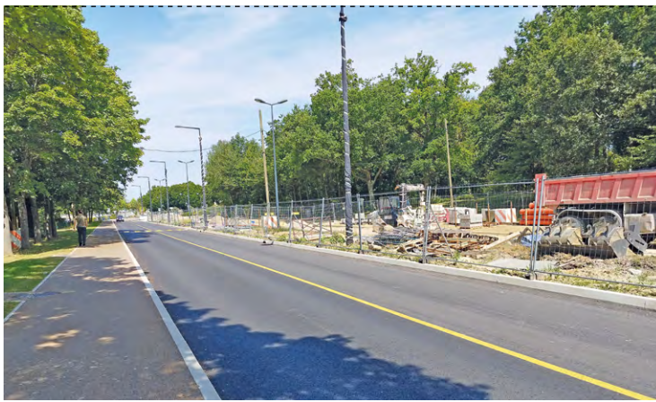
Le boulevard Michel Miserey va passer en 2x1 voie. La poursuite du chantier cet été, avec la fermeture de l'axe routier entre le 5 et le 9 août.
