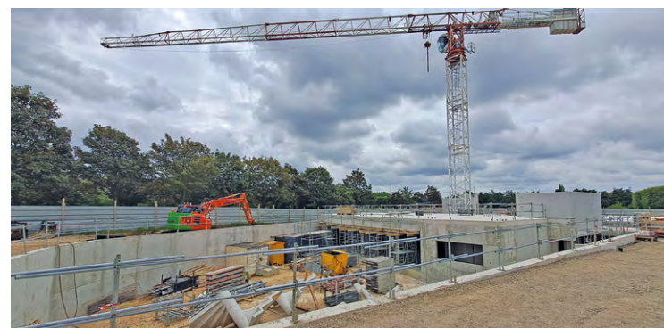
C'est sur ce terrain d'environ 7 000 m 2 , au cœur de la Zac Guyancourt II, rue de Dampierre, que sortira de terre d'ici mai 2025 le siège de la section R&D en Europe du groupe JST.
