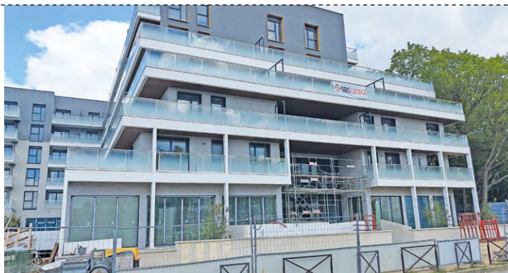
Les travaux de la Résidence services seniors (RSS), ont débuté en 2021 et sont bientôt terminés. L'ouverture au public est prévue pour le début du mois d'octobre 2024.
