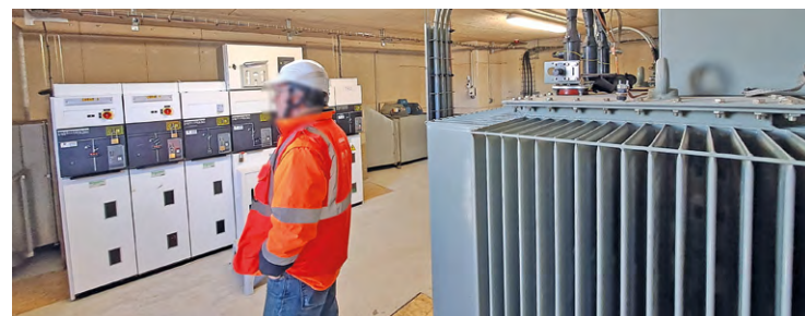
Le Vélodrome national a bénéficié de travaux de restructuration et de sécurisation du réseau, et pour la 1 re fois, utilisera un raccordement au réseau public d'électricité, pour de Jeux plus responsables.
