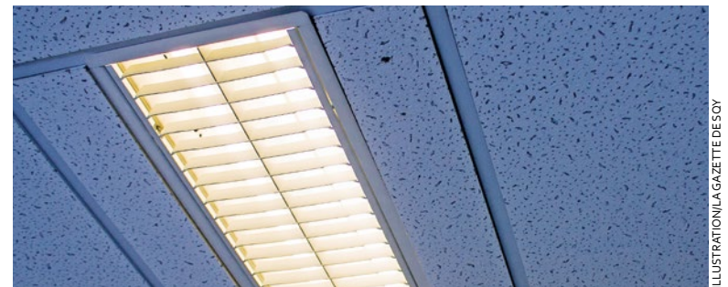
Le néon, vieillissant, a provoqué un court-circuit et un dégagement de fumée.
