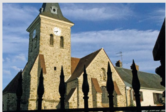
« On est en phase de finalisation, on devrait terminer les travaux courant octobre », assure Jean-Michel Chevallier, adjoint SE aux travaux et au patrimoine.
